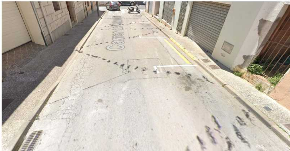
Imatge del mal estat asfalt Carrer Catalunya
