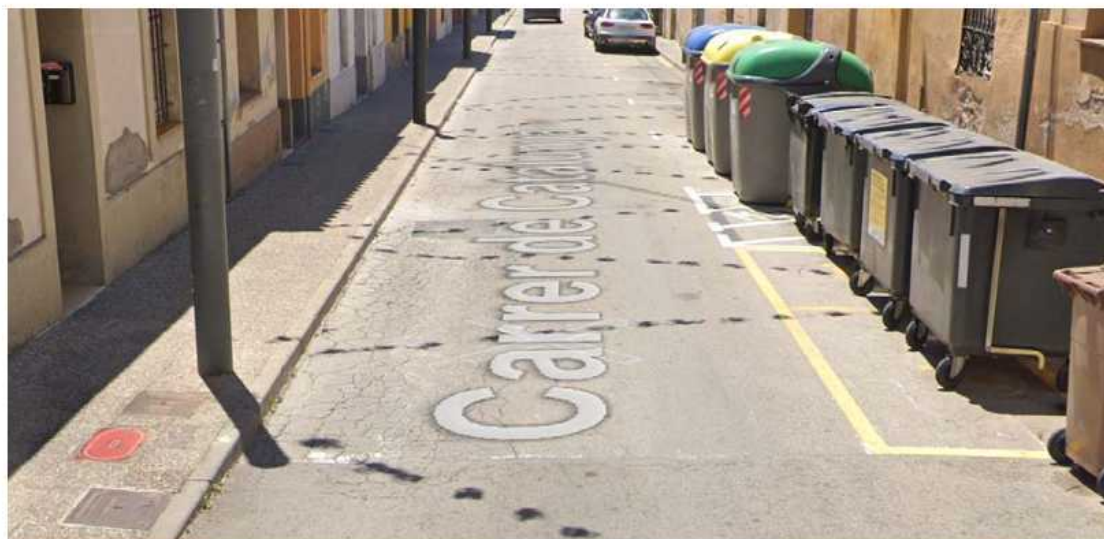
Imatge del mal estat asfalt Carrer Catalunya
