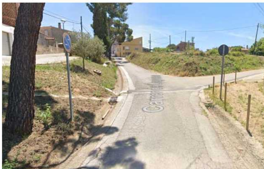
Imatge del mal estat asfalt Carrer de Llagostera
