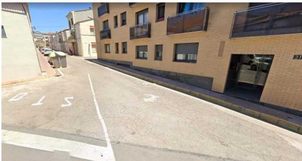
Imatge del mal estat asfalt Carrer de la Font
